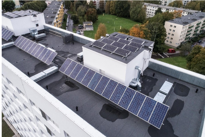
Joonis 2.2 KÜ Vilde tee 70 katusele rajatud päikesejaam, mis katab üldelektri vajaduse
