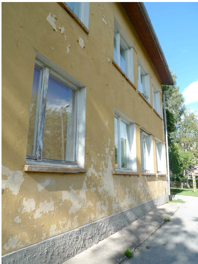
Pilt 1. Vanad aknad ja vihmavee toru viimane toru osa puudu
