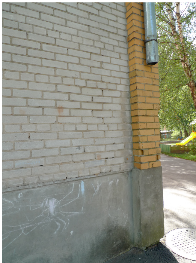
Pilt 1. Veerenni äravoolutoru vajab lisa toru, et vesi ära juhtida. Vundamendil on näha murenemisjälgi.
